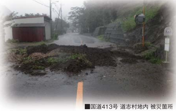
■国道413号 道志村地内 被災箇所
